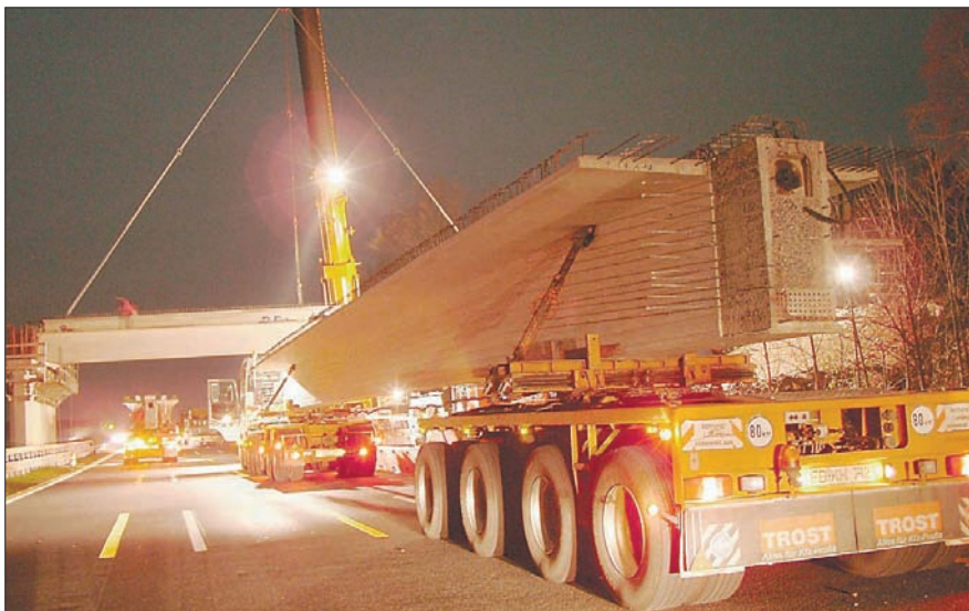
Mit einem Schwerlastkran wurden insgesamt zehn | Insgesamt 13 solcher Lkws fahren in der Nacht auf Spannbetonfertigteile auf vorbereitete Sockel gesetzt. | Sonntag an die Baustelle heran.
