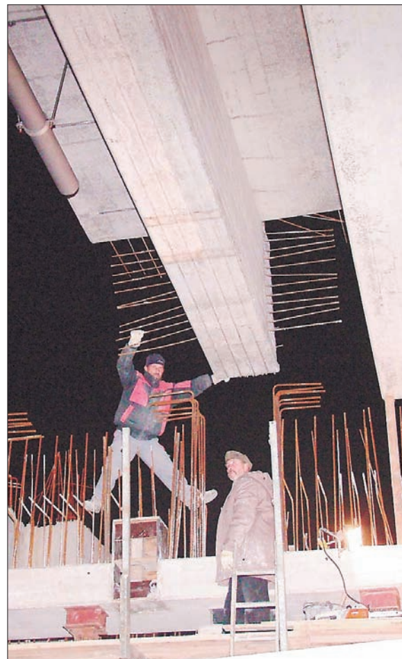
Millimeterarbeit. Monteure setzen den 60 Tonnen schweren Stahlbetonträger ein. Regen peitscht ihnen dabei ins Gesicht.
