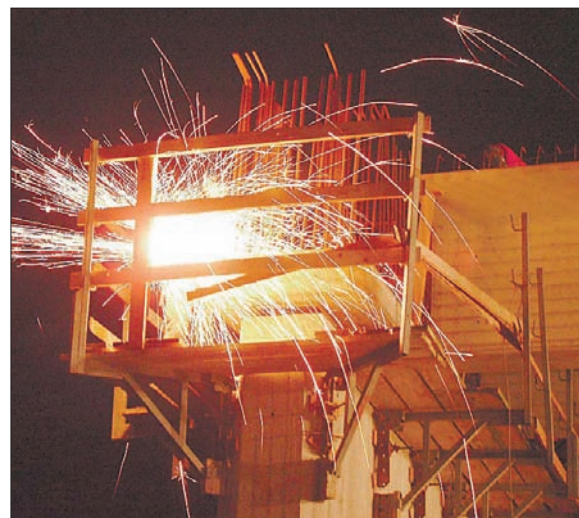
Feuerwerk. Bevor die Brückenträger eingesetzt werden, schweißen Mitarbeiter Absturzsicherungen und Arbeitsbühnen an.
